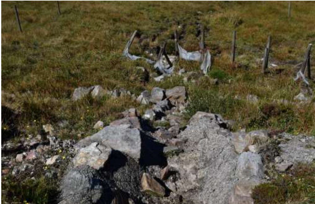
Figura 10.74. El diseño de las cunetas de los viales de los parques eólicos, así como de los puntos de evacuación del agua, generan zonas de erosión sobre los medios de turbera. En la fotografía un punto de evacuación del Parque Eólico de Chan do Lamoso – Chao do Lago (O Valadouro-Muras, Lugo).
