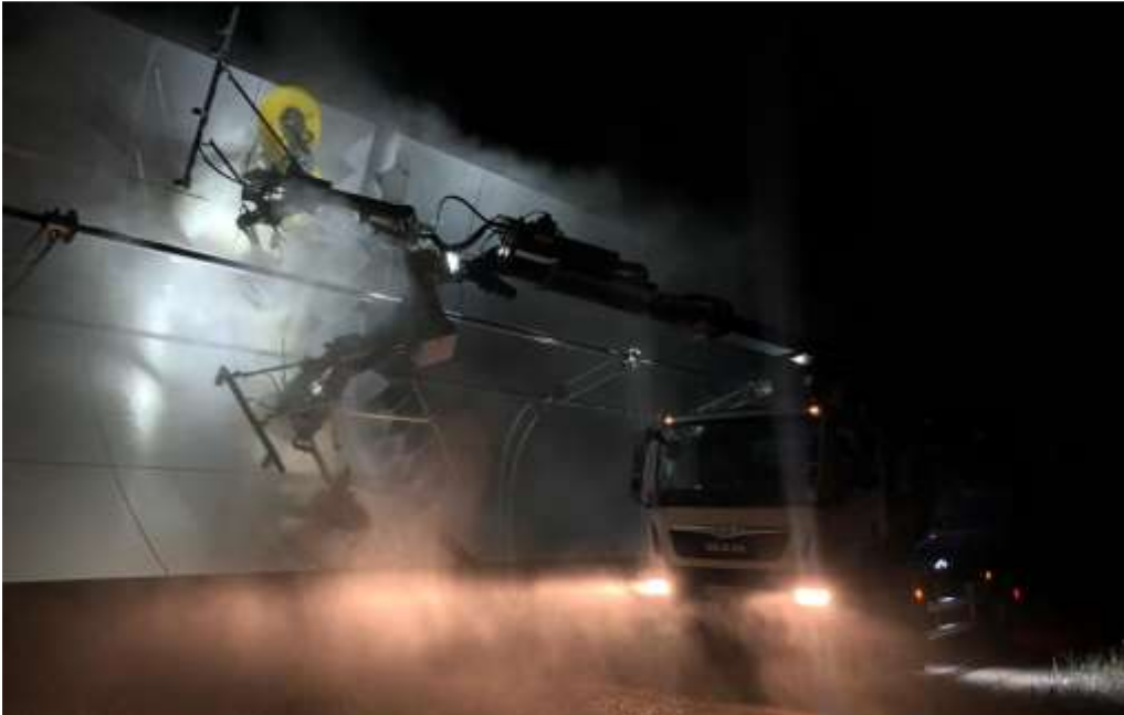
Figura 8.33. Ejemplo de limpieza mecánica en una Planta Termosolar durante el periodo nocturno. Imagen publicada en el Dossier de Trust Ingeniería de Mantenimiento (Olivenza, Badajoz).
