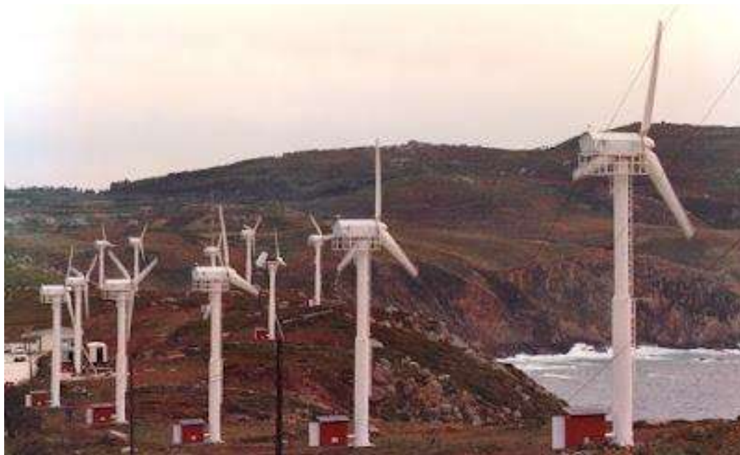
Figura 10.5. Parque Eólico de Estaca de Bares (Mañón, A Coruña). Fotografía: Dinamo. Revista de Ingeniería y Energía.
